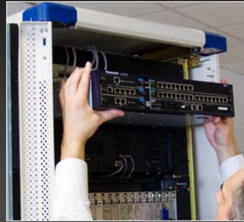
Standaard 19" Rack Installatie
